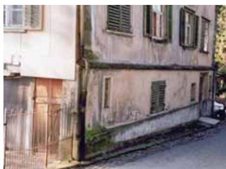
Aufsteigende Feuchtigkeit hat diese Fassade arg in Mitleidenschaft gezogen.
