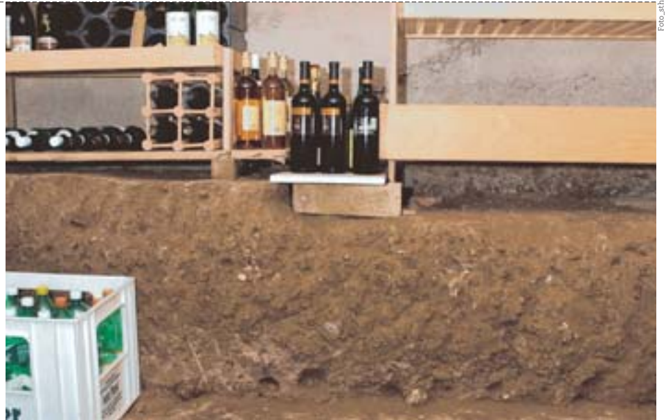
Unversiegelte Lehmböden im Keller können eine Gefahr bilden, wenn Decke und Türe zu den Wohnräumen schlecht isoliert sind.
