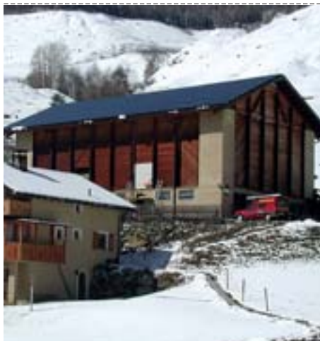
Solarstromanlage auf Stalldach in Sent (GR).
