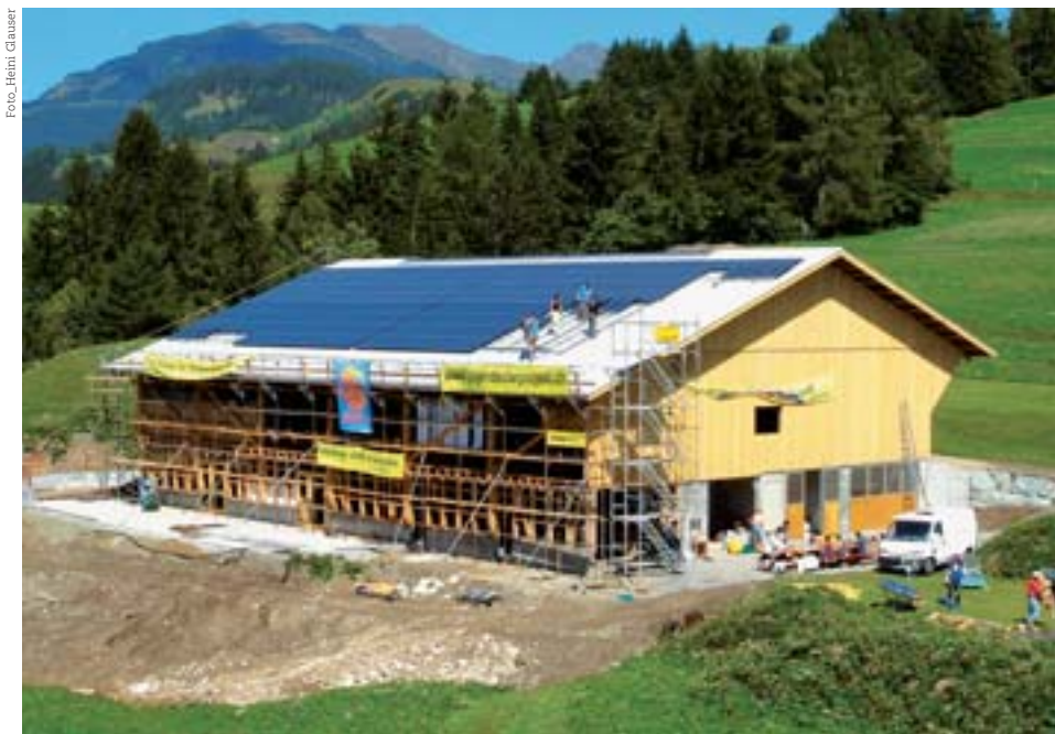
Viele Scheunendächer könnten mit Fotovoltaikzellen zur Stromgewinnung bestückt werden wie im Bild die 35-kW-PV-Anlage in Brienz (GR).
