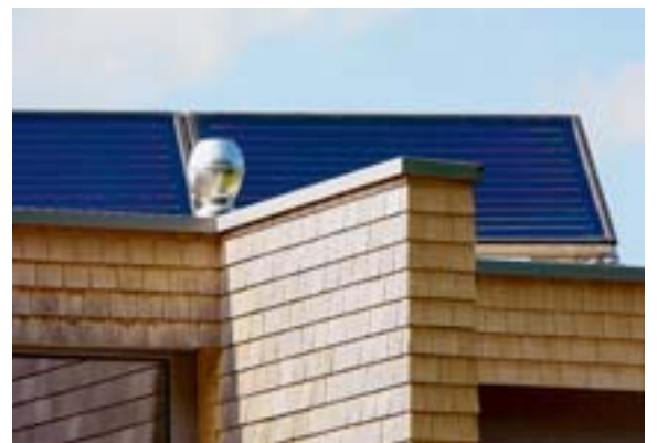
10 m 2 Sonnenkollektoren erwärmen das Brauchwasser der drei Wohnungen.
