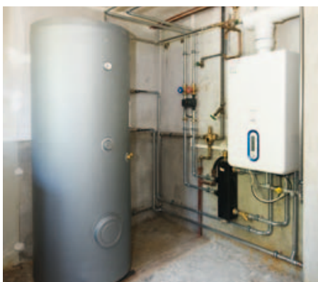
Heizanlage und Boiler.
