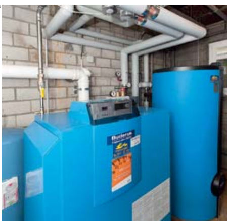
Die Heizanlage im Keller.
