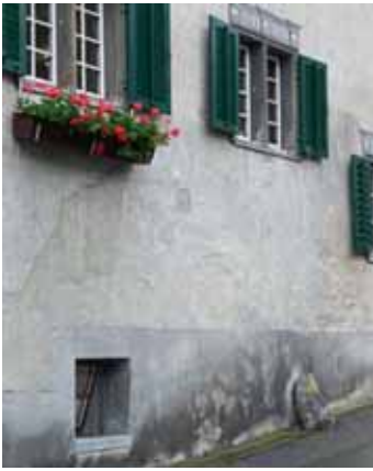
Aufsteigende Feuchtigkeit beschädigt Mauern.
