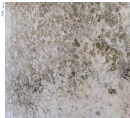
Schimmelpilz: Vorbeugen, erkennen, entfernen_08
