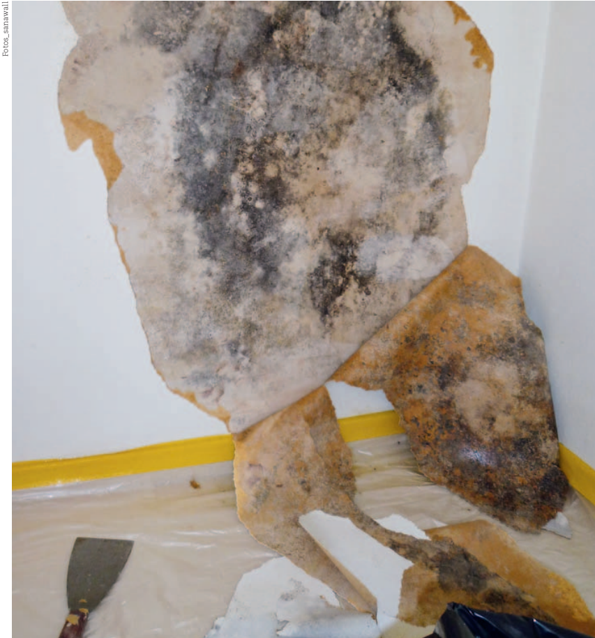
Der Schimmelpilz befällt nicht nur die Tapete, sondern auch die unteren Schichten.
