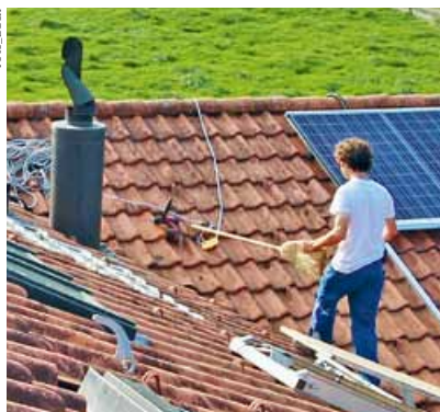
Stromallmend: Grösstes dezentrales Solarkraftwerk der Schweiz_15
